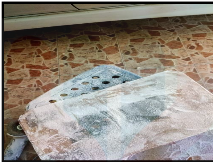
Rajah 4.9.13: Menunjukkan permukaan papan epoxy yang telah digosok bagi menghilangkan buih-buih yang mencacatkan permukaan.
