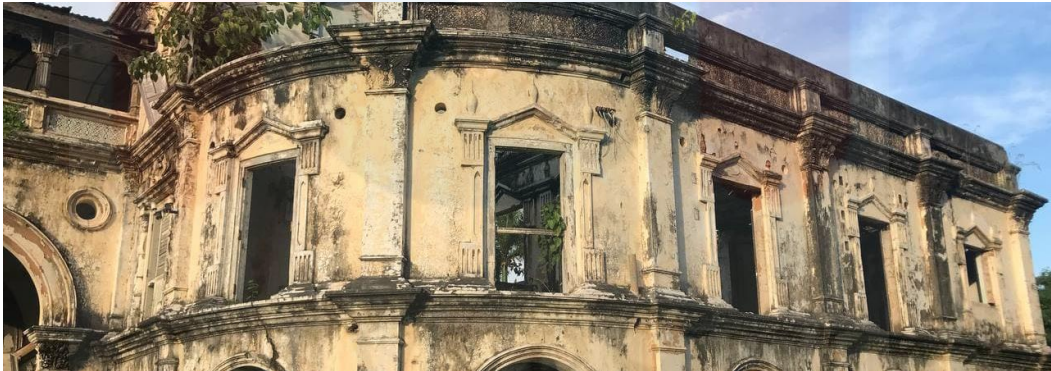
Gambar 4.30 menunjukkan keadaan bangunan istana yang telah hilang tingkapnya.
