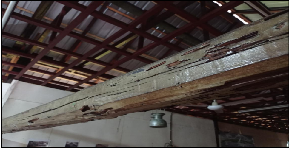
Rajah 4.2.4 : Kayu belian yang masih dikekalkan dalam Rumah Tradisional Melanau Panjang di Kampung Sok, Matu, Mukah
