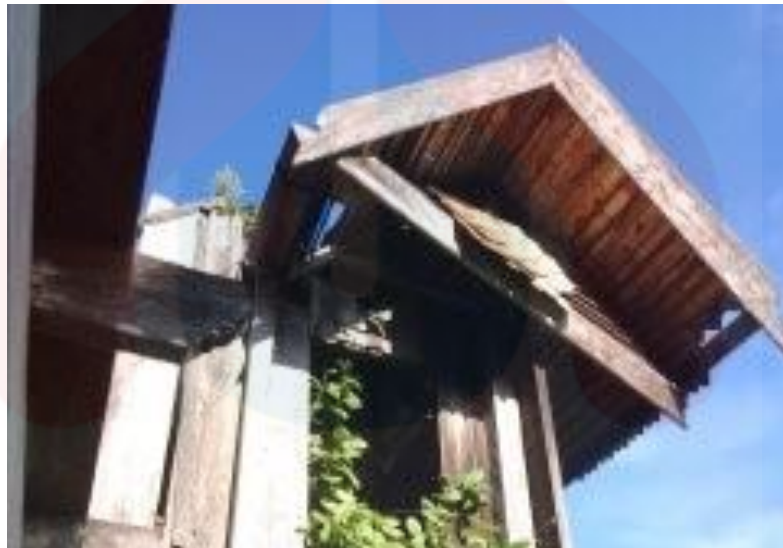
Rajah 4.12 Struktur atap rumah Pura Tanjung Sabtu yang roboh.
