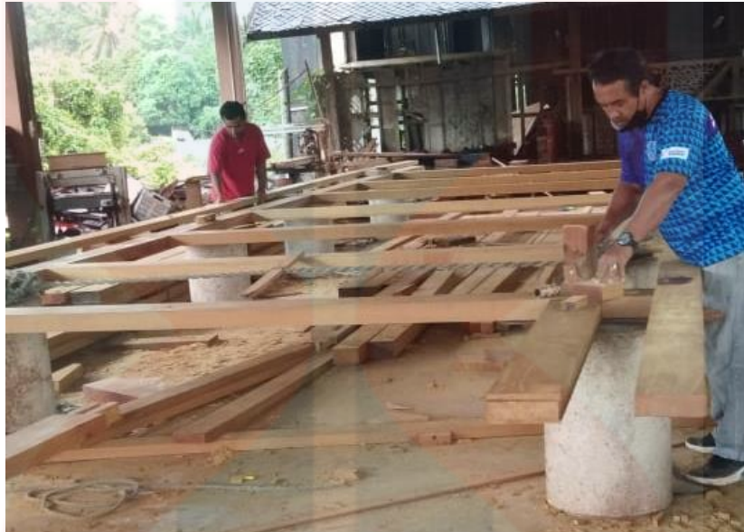
Rajah 4.5 Kerja-kerja proses nanggung iaitu pasang di bawah hingga siap, buka dan pasang semula di atas.
