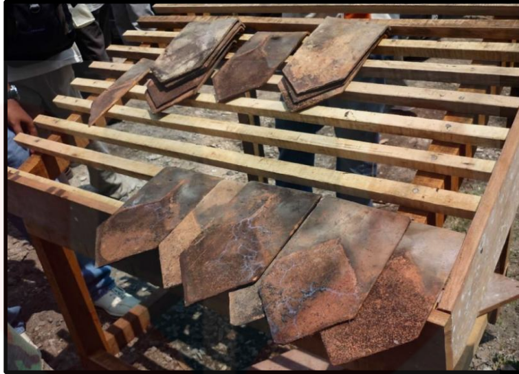
Rajah 2.9 : Keadaan atap singgora yang sudah rapuh akibat kerosakan semulajadi
