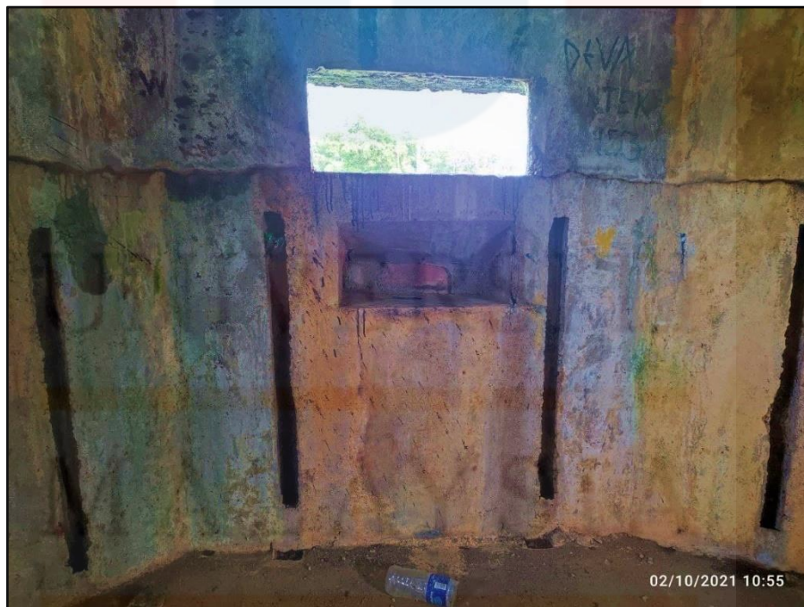
GAMBAR 4.50 : Elemen para kayu yang telah hilang daripada tempat asalnya.
