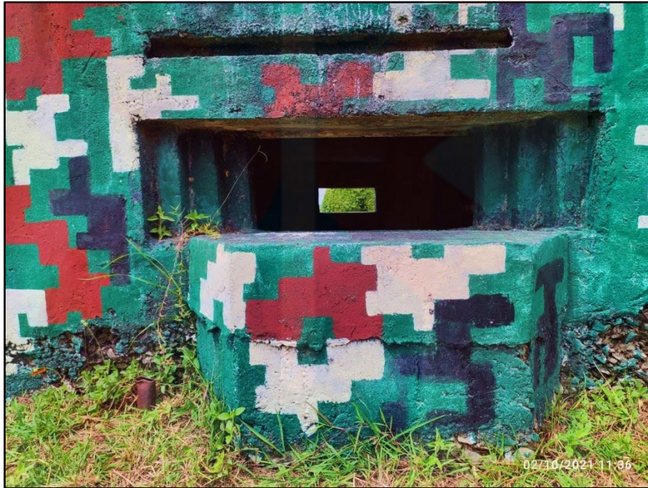
GAMBAR 4.34 : 'Buttress' Type B pada kubu kebal (pillbox) 'Type 22'
