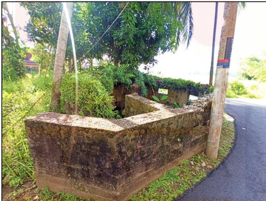
GAMBAR 4.52 : Elemen bumbung pada kubu kebal ( pillbox ) Type 22 yang telah hilang.
