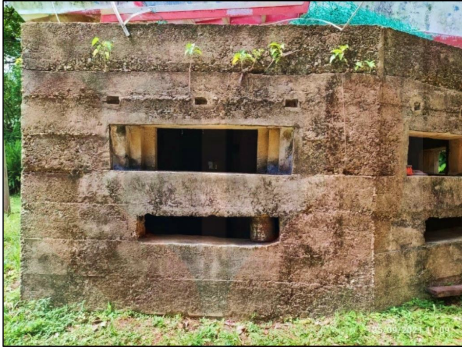
GAMBAR 4.51 : Kubu kebal ( pillbox ) Type 22 yang tidak mempunyai struktur ' buttress '.
