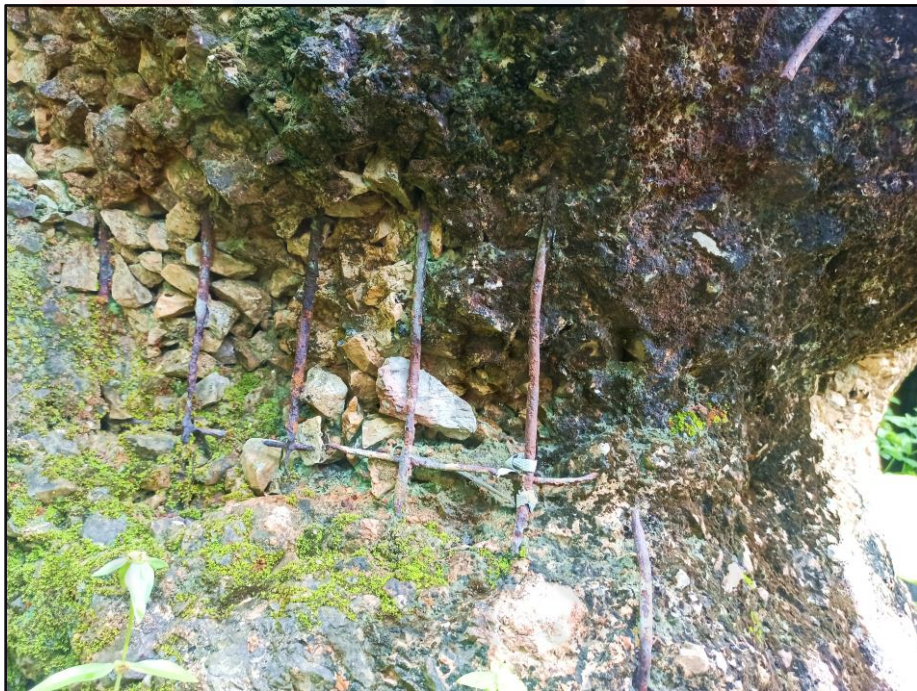
GAMBAR 4.60 : Elemen dinding yang mengalami kerosakan kecil.
