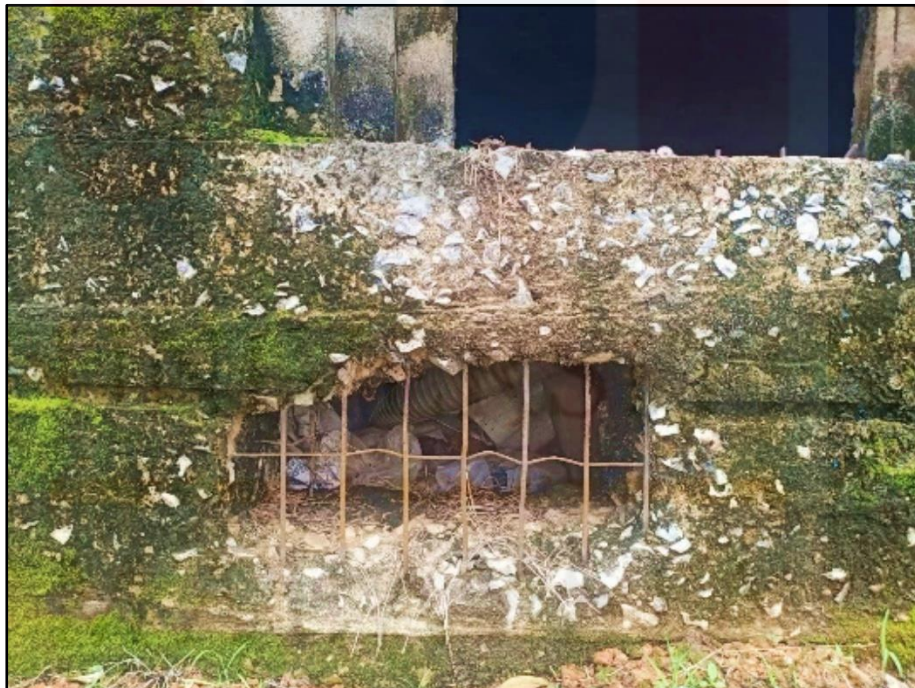
GAMBAR 4.58 : Elemen dinding kubu kebal ( pillbox ) 'Pentagon' yang telah mengalami kerosakan kecil.
