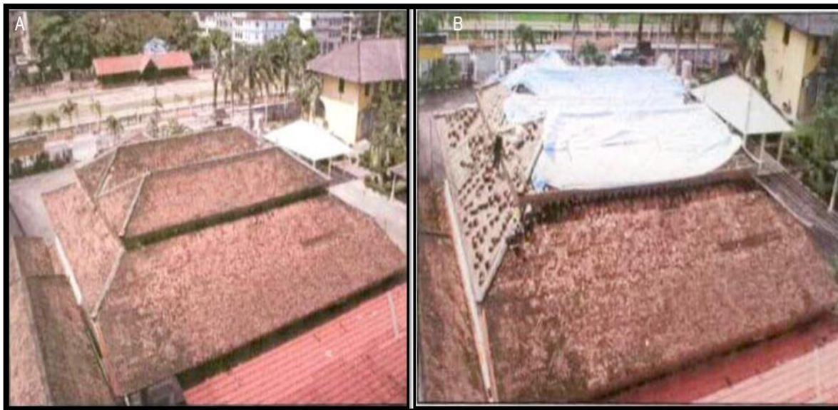
Gambar 4.7 : Gambar bumbung sebelum konservasi (A) dan gambar bumbung semasa konservasi (B) (Sumber : Norsyazwani Din, 2021)
