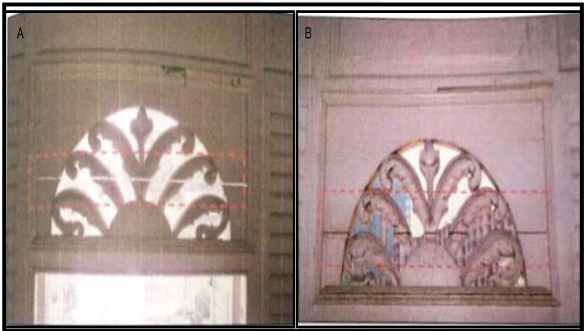
Gambar 4.14: Ukiran kepala tingkap yang renggang sebelum dikonservasi (A) dan Ukiran kepala tingkap yang telah dibaikpulih (B) (Sumber : Norsyazwani Din, 2021)
