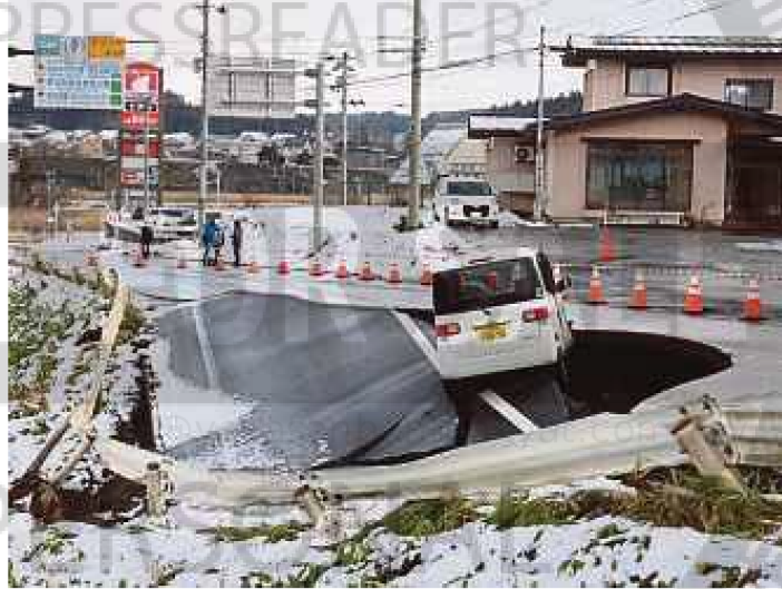
KENDERAAN yang rosak akibat jalan raya rosak selepas gempa bumi melanda bandar Tohoku, wilayah Aomori.
