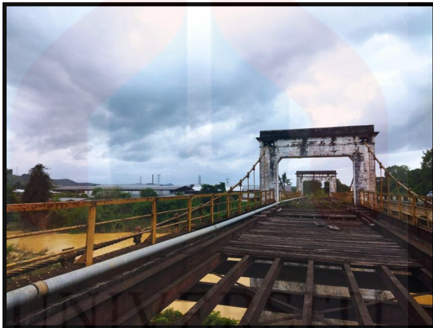
Gambar 2.6: Kerosakan yang dialami Jambatan Sultan Ismail Petra
